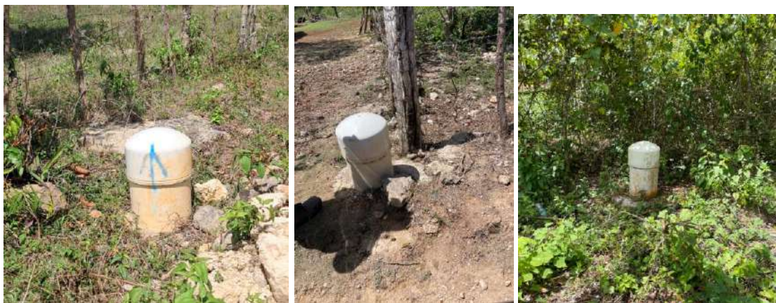
Imagen No. 112. Pozo existente en la coordenada UTM 19Q 549915 2064020 (izquierda), 19Q 550206 2063873 (Centro), 19Q 551438 2062520 (derecha)
