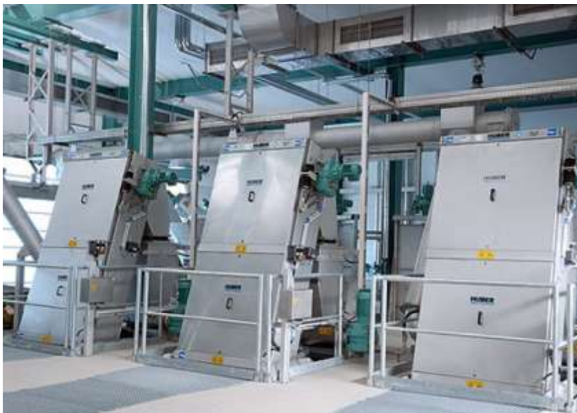
Figura 10 – Rejilla de barras mecanizada
