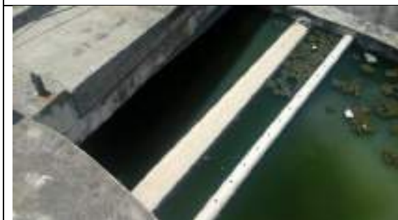
Foto 09: Déficit en el funcionamiento de distribuidores.
