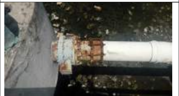
Foto 08: Oxidación de elementos metálicos.
