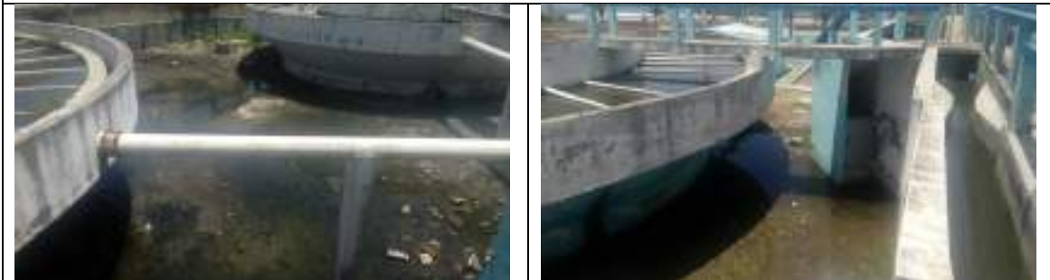
Fotos 03 y 04: Filtraciones en urbanización.
