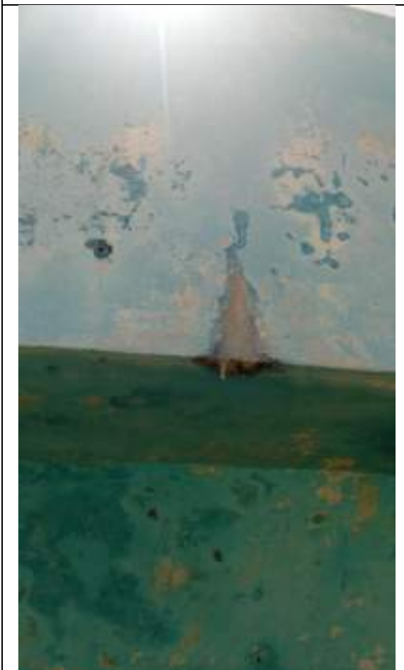
Foto 15: Exudación del concreto.
