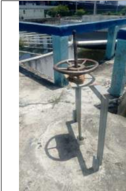
Foto 05: Desperfectos geométricos por deficiente instalación o sobvenidos con posterioridad.
