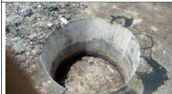
Foto 07: Obstrucciones en elementos de la planta.
