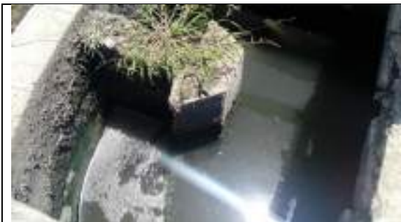
Foto 11: Estancamiento de aguas.
