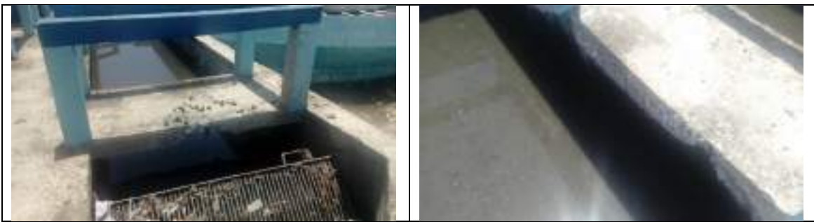
Fotos 01 y 02: Pérdida de resistencia en concreto.
