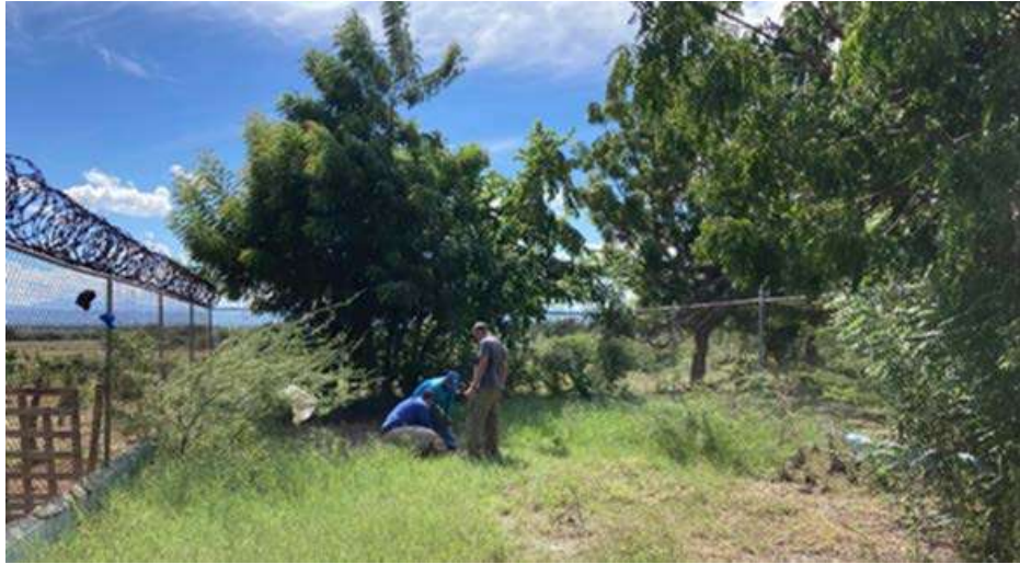
Figura: Cajas de corte y derivación cercadas # 7 (Villa Elisa – Línea B)
