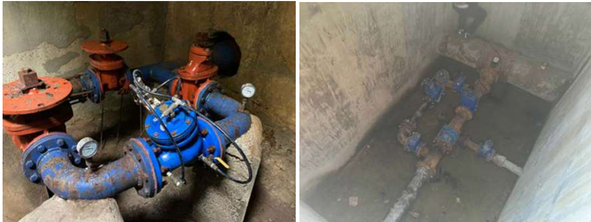
Figura: Cajas de derivación # 7 (Línea B) y 16 (Línea A)
