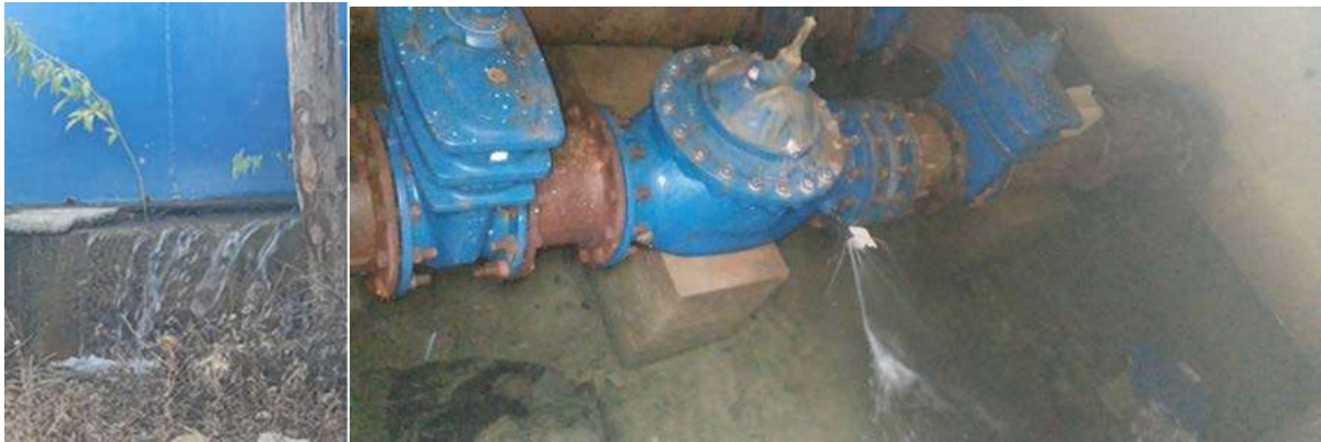
Figura: Casos de fugas en el fondo de los depósitos (Tanque de Montecristi) y a nivel de las válvulas (Tanque de Navarrete)
