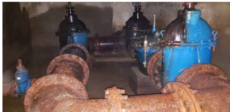
Figura: Cajas de derivación hacia los tanques de Mao (Línea A)
