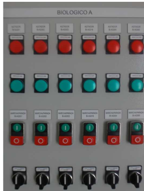
Figura 32. Vista del armario AT2 con los selectores y botones del BIO A
