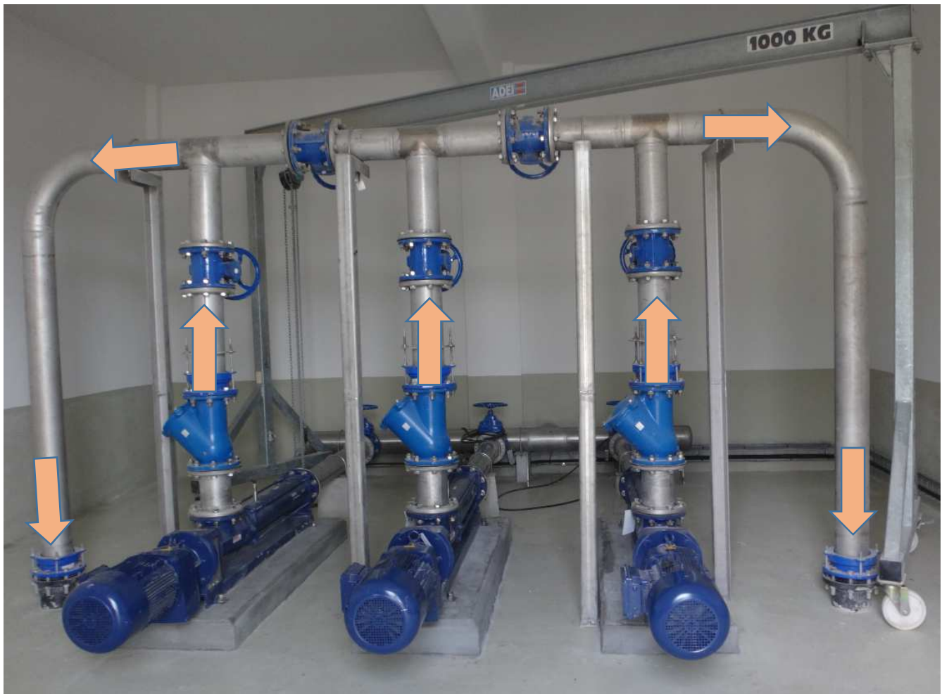
Figura 53. Estación de bombeo de los lodos líquidos
