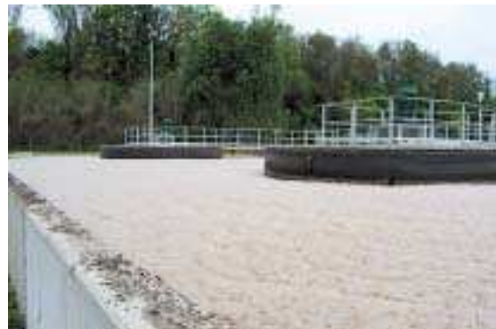
Figure 6 – Mousse biologique en surface de bassin d'aération
