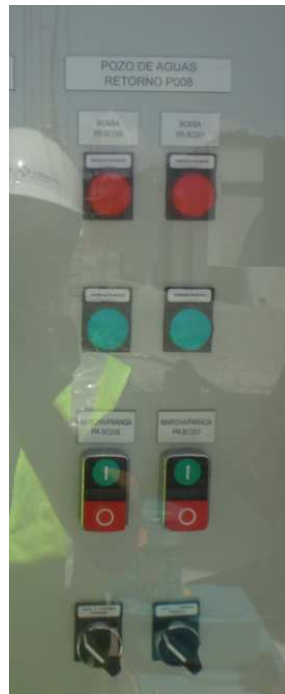
Figura 56. Botones sobre el armario AT1-Bis para operación manual del pozo de aguas de retorno P008
