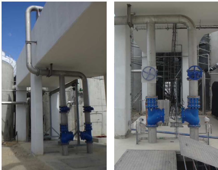
Figura 54. Línea de impulsión del pozo de aguas de retorno P008
