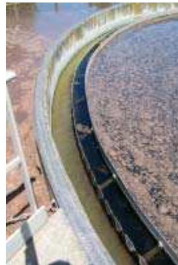
Figure 9 – Flottants de dénitrification en surface du clarificateur
