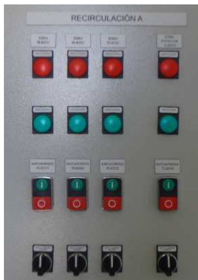
Figura 47. Botones sobre el armario AT2 para operación manual del pozo A
