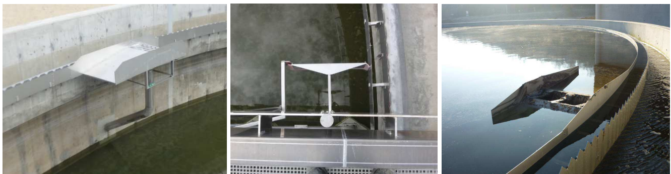
Figura 40. Canal de salida del agua clarificada, vertedero triangular, chapa deflectora y tolva de recogida de flotantes
